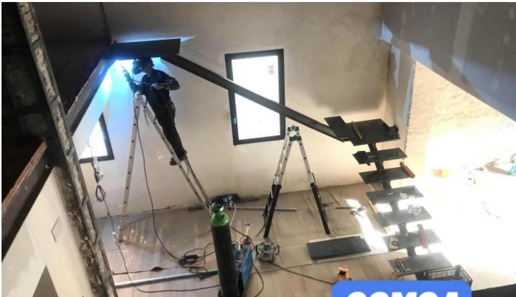
Cerrajería dape sl interior
