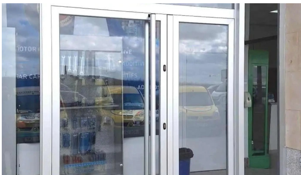
Cerrajería luengo interior
